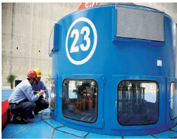
图9 哈电自主制造的三峡右岸电站23号700MW水电机组
