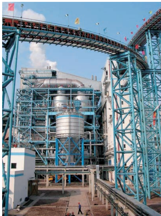
图7 东锅通过技贸结合、引进法国阿尔斯通公司设计制造技术研制的四川白马电站示范工程300MW循环流化床锅炉现场
