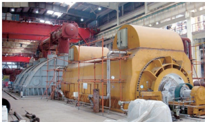
图6 东汽为宁夏灵武电厂二期研制的全球首台1000MW超（超）临界直接空冷机组
